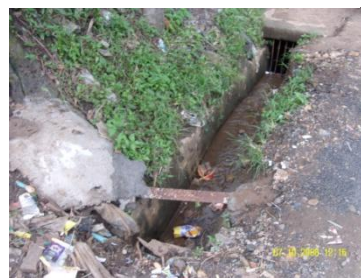
Figura nº 41 Sistema de cañerías comunidad Río Azul
