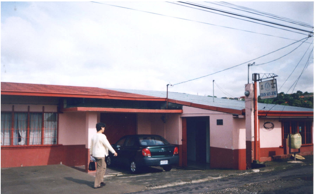
Sede I EBAIS San Josecito, San Isidro de Heredia. Estacionamiento no cumple con dimensiones ni Ley 7600.
