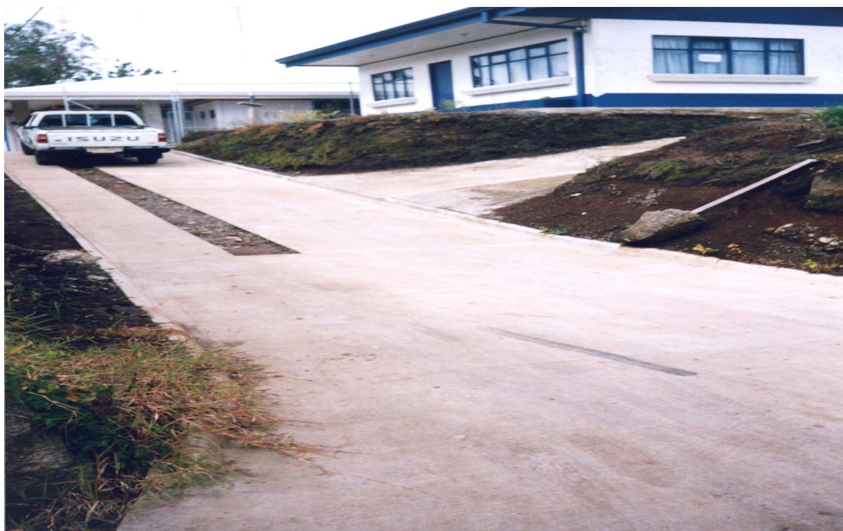
Sede I EBAIS San Luis de Santo Domingo, Heredia. Pendiente de la rampa y accesibilidad no cumplen con la Ley 7600.
